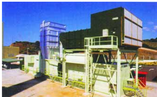
Turbines de gas.
